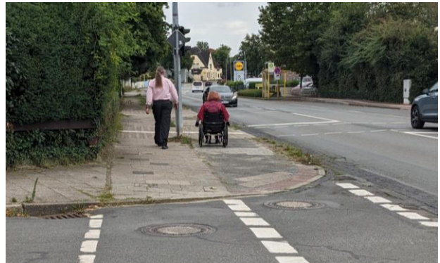
Exemplarische Situation: unebener und beschädigter Gehweg entlang der Sieverner Straße in Langen
